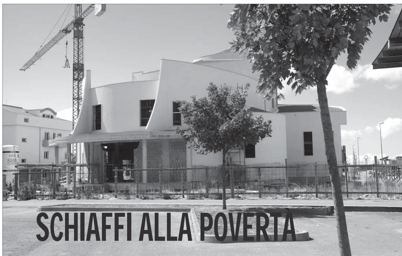
A San Giovanni Rotondo dopo la “chiocciola” di Renzo Piano è in via di ultimazione un complesso parrocchiale di tre edifici con chiesa che deve sostituire la piccola, semplice e disadorna cappelletta ottagonale della Trasfigurazione
